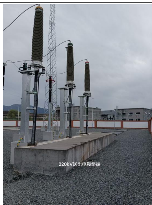
220kV 地下电缆线路终点：中车 220kV 升压站
