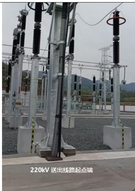
220kV 地下电缆线路起点：220kV 升压站（百世二）
