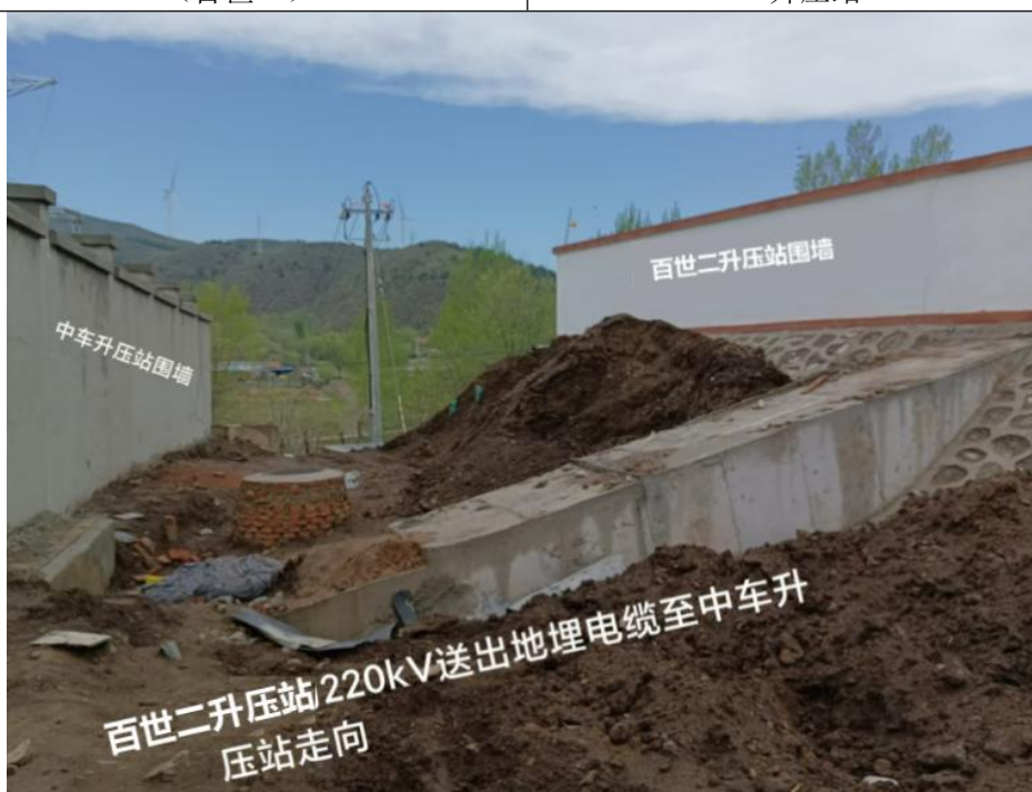
起点及终点 220kV 升压站之间地下电缆线路
