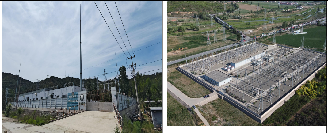
图 3-9 终点巴克什营变电站现状图
