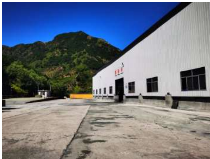
图 3.1-4 厂区内道路破损情况
