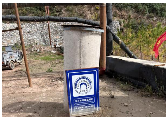
图 2 截渗墙内地下水监测井
