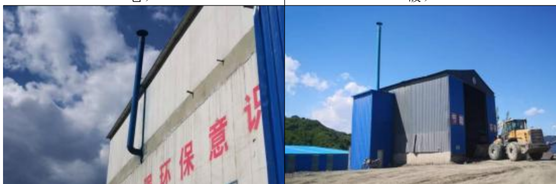
3号除尘器排气筒（1#破碎车间干选和筛分及废石分选车间筛分）
