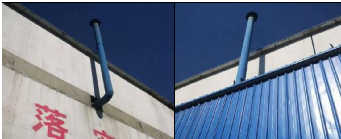
1号除尘器排气筒（1#破碎车间粗破及受料仓）
