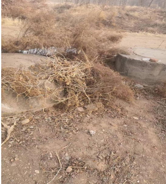
起点处现状污水检查井
